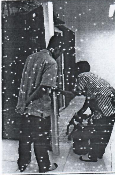
Perawatan di Ruang Data Center BKN Pusat
