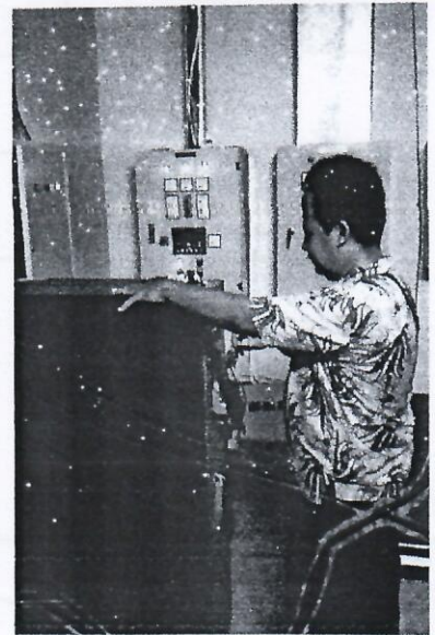
Pemeriksaan UPS di BKN Pusbang
